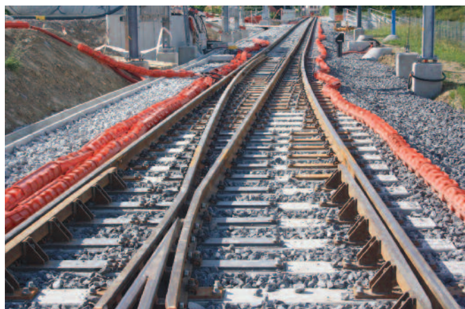
Bulle. Aiguillage à la bifurcation des voies Bulle-Broc et Bulle-Montbovon. A gauche, direction Montbovon, à droite, la nouvelle voie normale pour Broc.
